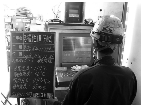
写真7 光照射装置操作盤
