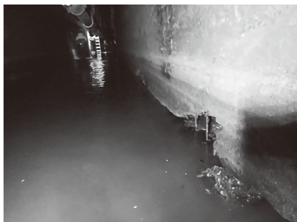
写真6 既設管きよ側壁下部の損傷例
