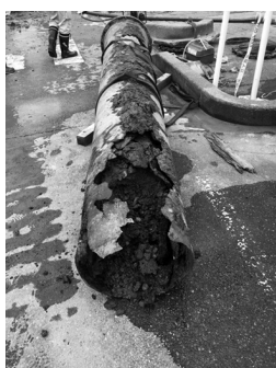
写真1 陥没状況（上）と腐食したDIP管（下）
