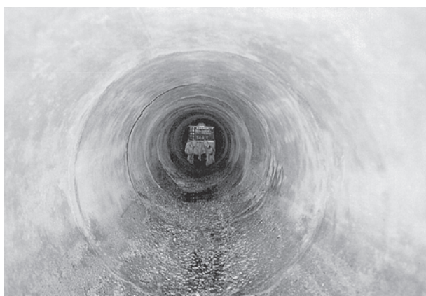
老朽管の状況 (2)
